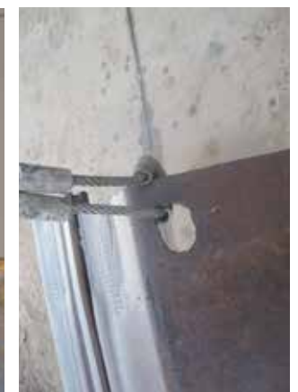
Verkeerd aangeslagen damwandstrop
