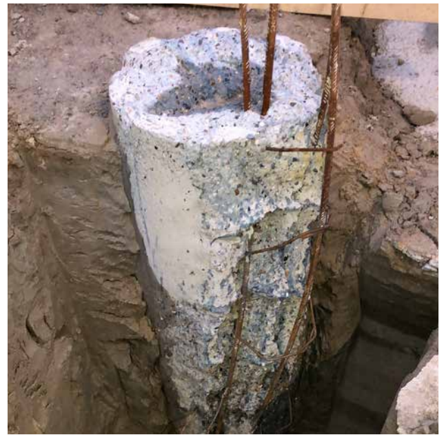
Lage consistentie, versneld opstijven van de mortel door warmte in de boorbuis of ontmenging nabij de punt kan leiden tot torderen van de wapening bij het oscillerend trekken. Hier is ook uitspoeling te constateren.
