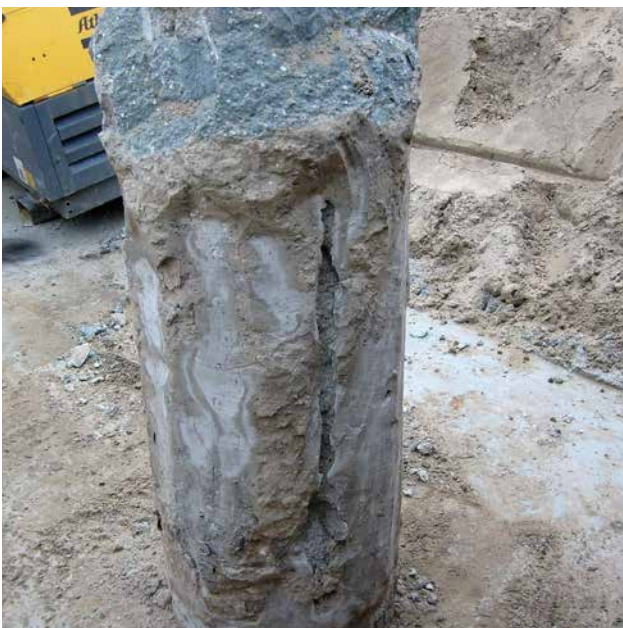
Verhoogde grondwaterspanning kan leiden tot het ontstaan van waterkanalen in het verse beton. Ook bleeding kan dit fenomeen veroorzaken, met uitspoeling van fijne delen tot gevolg.
